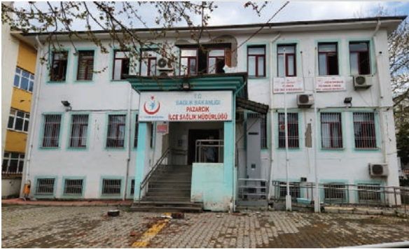
Ağır Hasarlı Pazarcık İlçe Sağlık Müdürlüğü
